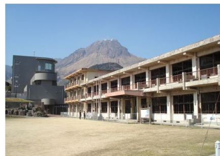
폭발 후: 건물 내부는 화재로 소실되고 골조만 남음
