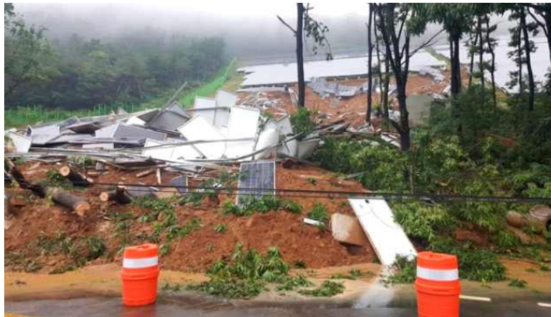
: (위) 조선일보(2018.6.28), “태양광이 환경파괴 ... 10년간 여의도 10배 산지 훼손”, 검색일: 2018.10.3; (아래) 조선일보(2018.7.4), “경북 청도, 폭우로 산사태 ‘태양광 시설’ 파괴”, 검색일: 2018.10.3.
